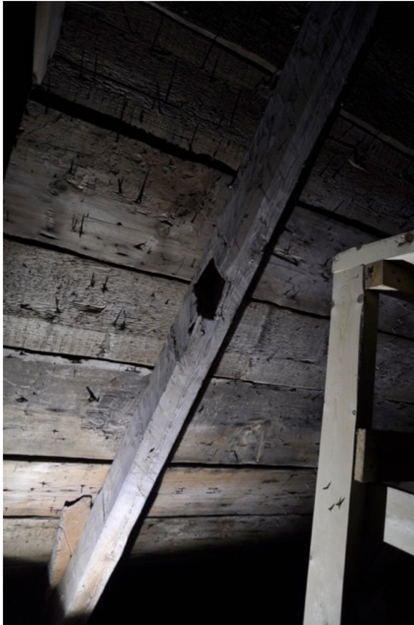
Ett återanvänt högben, som nu återigen utgör högben i tornhuven. Mitt på högbenet syns en "husad" knut, d.v.s. att knuthaket löper inte hela vägen tvärs över högbenet.
